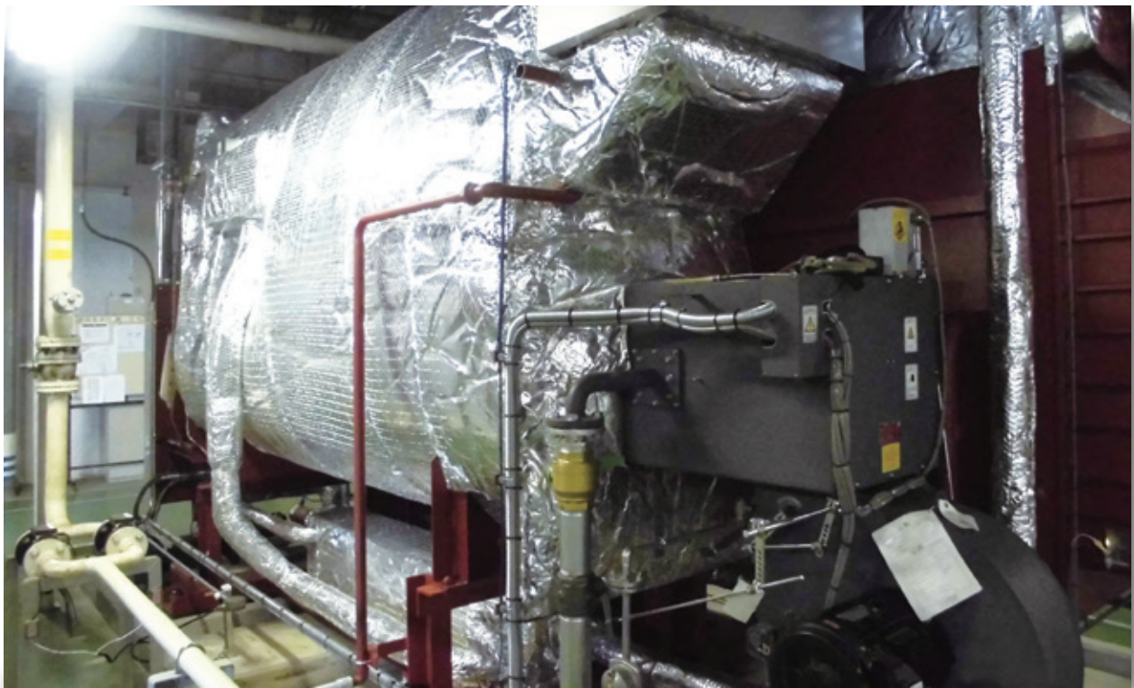
▲ ガス吸収式冷温水機更新(屋内設置)
