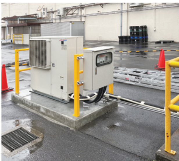
▲ 冷凍機・制御盤
