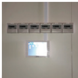
▲ 空調冷熱 総合監視システム
