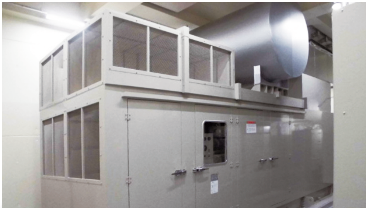
▲ 発電機室内非常用発電機設置
