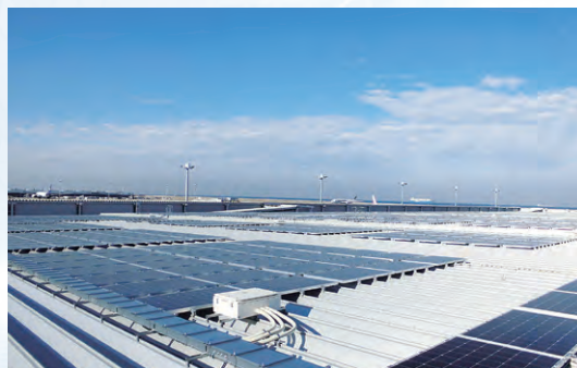
【事例】関西空港にメガソーラーを納入
