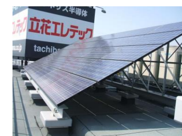
弊社南大阪支店 太陽光発電システム
